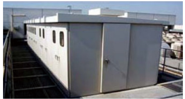
6KV 受電設備 (於：紙加工工場)
