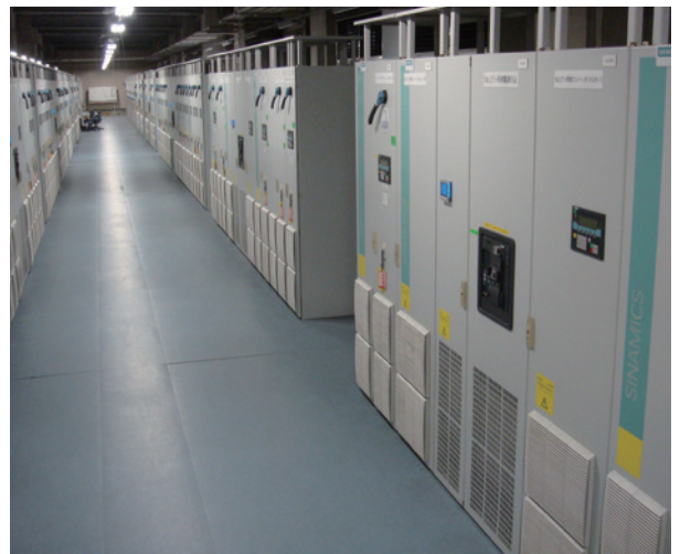
大型抄紙機 駆動制御装置 (電気室) (於：製紙工場)
