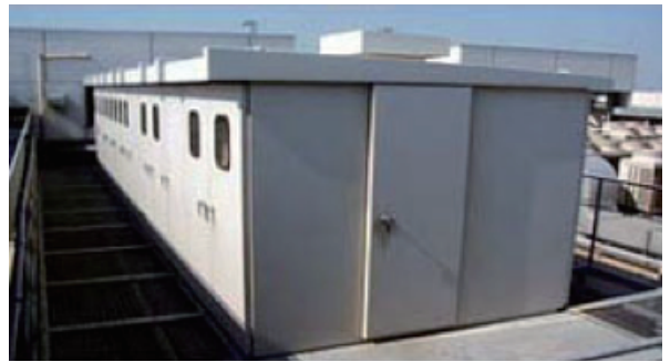
6KV 受電設備 (於：紙加工工場)
