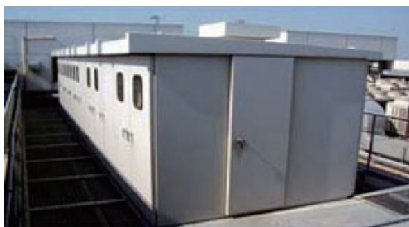
6KV 受電設備 (於：紙加工工場)
